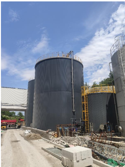
调节罐和厌氧罐
