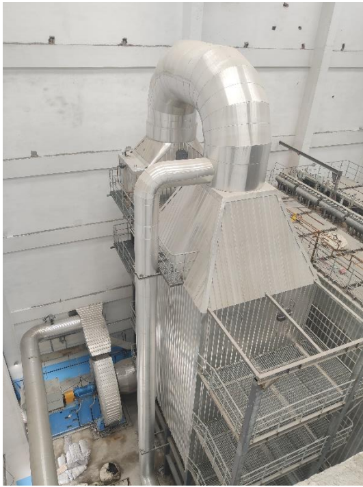
废气处理设施
