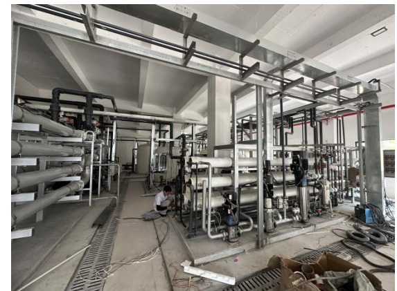
污水处理站（纳滤、反渗透系统）
