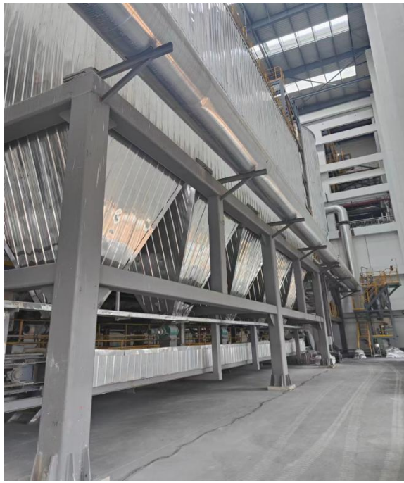
焚烧炉烟气治理设施（高效布袋除尘器）
