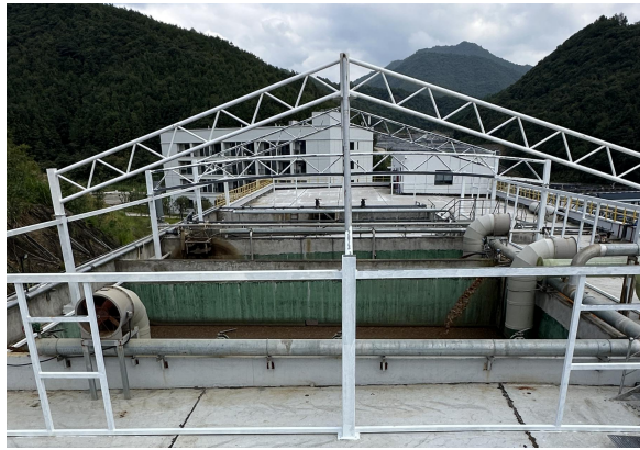
污水处理站（反硝化+硝化）
