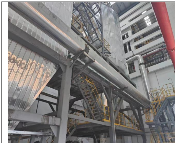
焚烧炉烟气治理设施（半干法脱酸）
