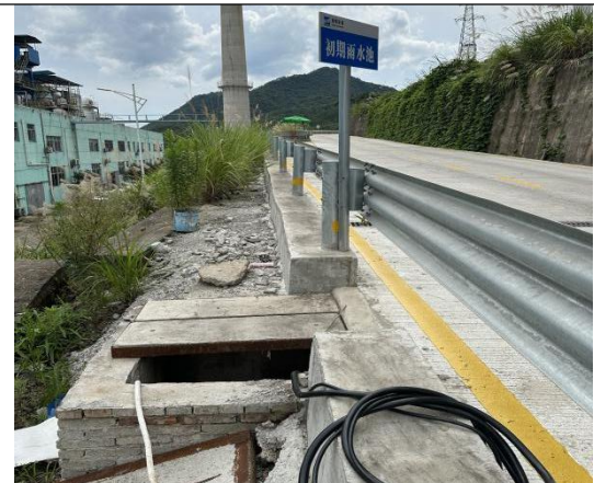
厂区雨水排放口 30m 3 集水井并设有提升泵
