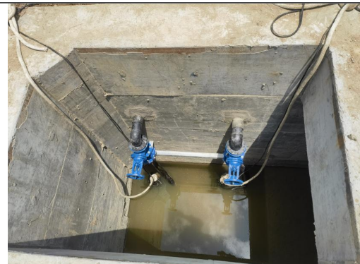
生产雨水排放口及切换阀门
