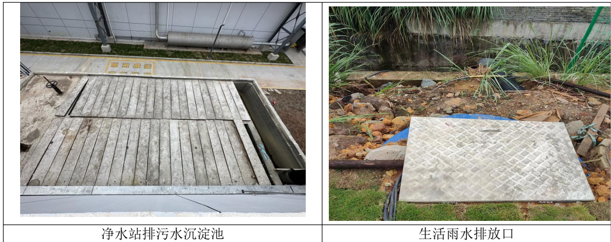
图 4.1-3 废水治理设施图片
