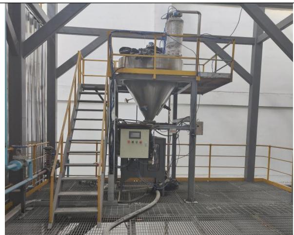
焚烧炉烟气治理设施（活性炭装置）
