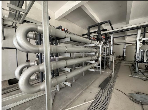
污水处理站（超滤系统）
